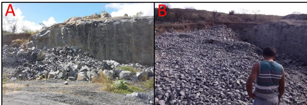
Figura 2. Resultado do desmonte de rocha: plano de fogo antigo (A) e plano de fogo proposto (B).
