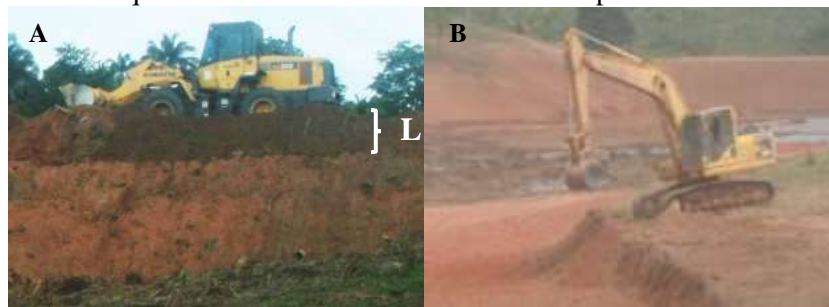
Figura 7. Construção de diques: A) Dique sendo erguido por camadas a partir do nível natural do solo e B) Inclinação do talude dique construído abaixo do nível natural após corte do solo.
