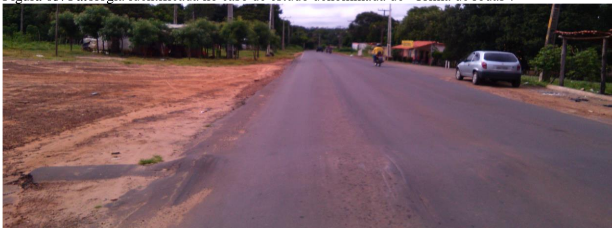
Figura 03. Patologia identificada no caso de estudo denominada de “Trilha de rodas”.
