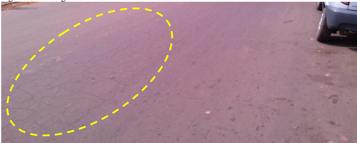
Figura 05. Patologia identificada no caso de estudo denominada de “Fissuras”
