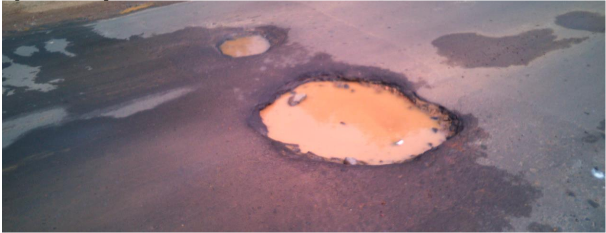
Figura 06. Patologia identificada no caso de estudo denominada de “Panelas”
