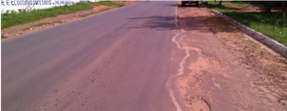
Figura 04. Patologia identificada no caso de estudo denominada de “Escorregamentos”.
