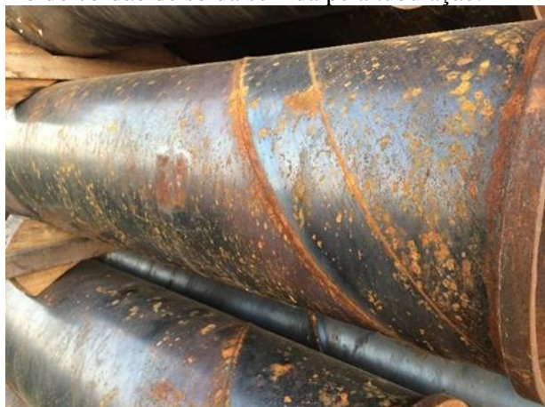
Figura 1. Corrosão em torno do cordão de solda sofrida pela tubulação.
