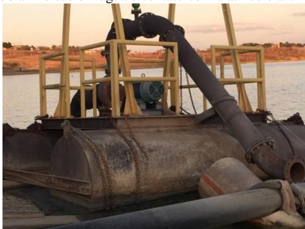
Figura 2. Corrosão devido a imersão em água e contato com a atmosfera úmida.
