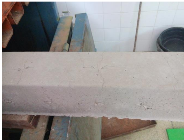
Figura7 – Aparecimento de fissura
