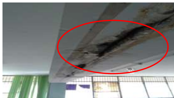
Figura 6. Disgregação do concreto
