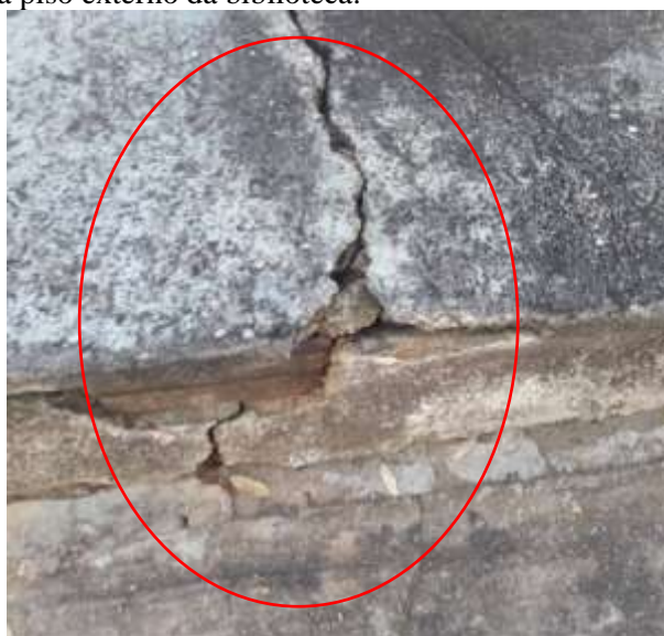
Figura 3. Fissura no contra piso externo da biblioteca.
