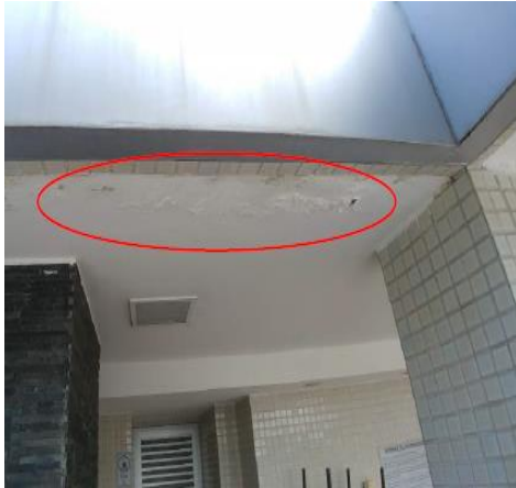
Figura 3: Infiltração no teto da churrasqueira. Fonte: Autor, 2020.
