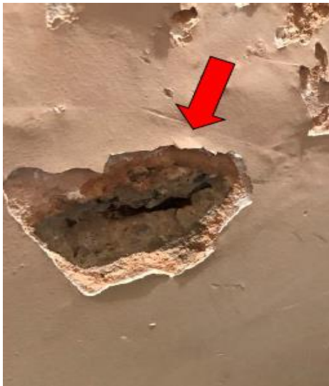
Figura 7: Oxidação de armadura, estufamento e destacamento Fonte: Autor, 2020.
