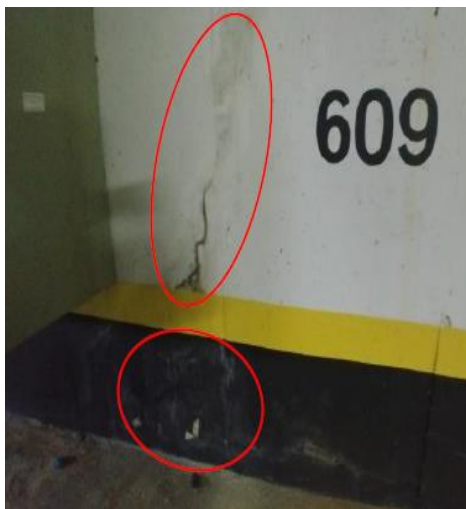
Figura 8: Infiltração nas cortinas de contenção Fonte: Autor, 2020.
