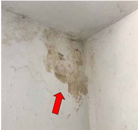
Figura 6: Infiltração no teto e parede na Casa de máquinas. Fonte: Autor, 2020.
