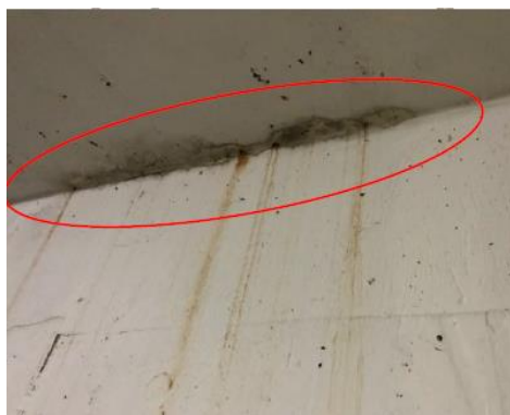
Figura 9: Infiltração no teto do subsolo Fonte: Autor, 2020.
