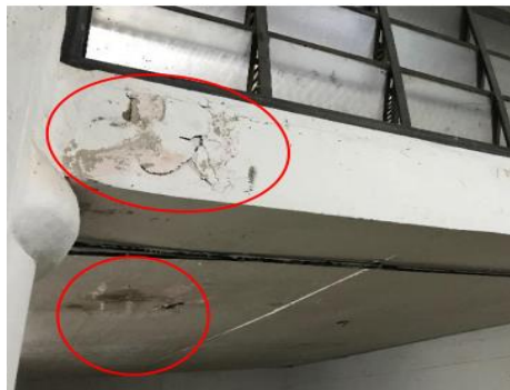
Figura 5: Oxidação da armadura no teto da garagem. Fonte: Autor, 2020.
