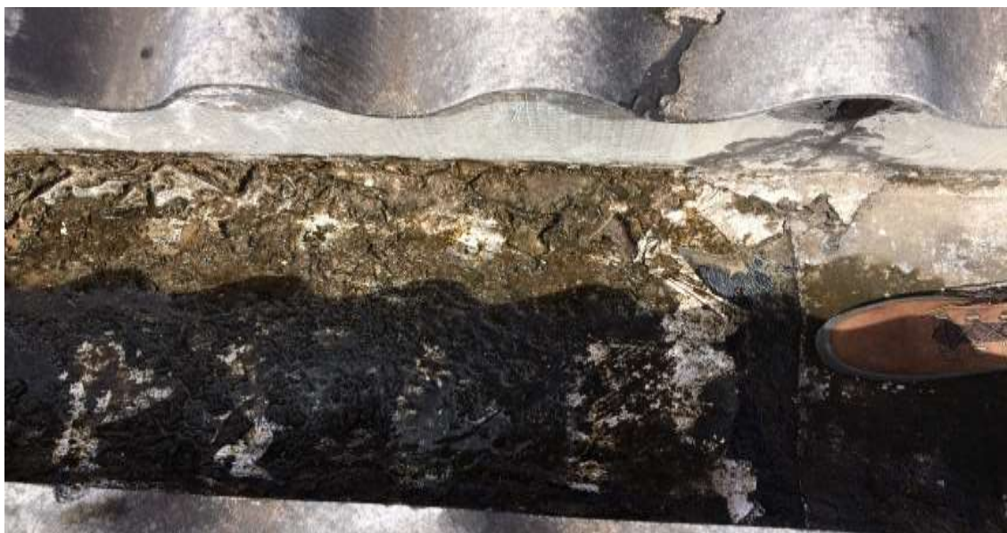
Figura 1 – Degradação de manta asfáltica
