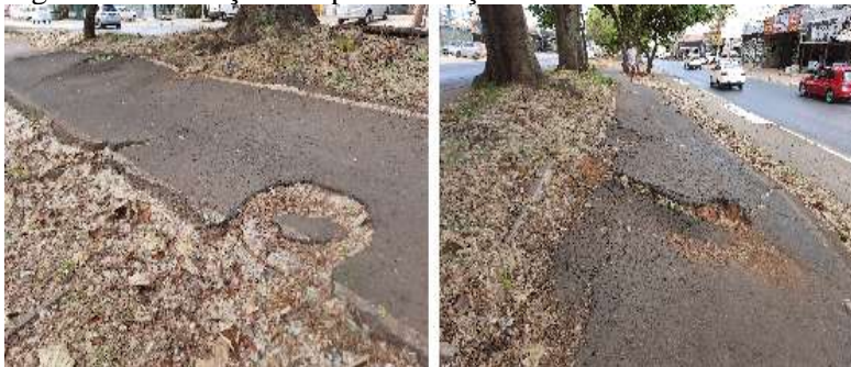
Figura 11- Condições de pavimentação da Via MN2 Sul
