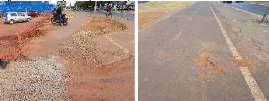
Figura 52- Condições de pavimentação da Via M1 Sul
