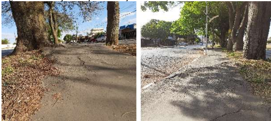
Figura 8 - Condições de pavimentação da Via M1 Norte
