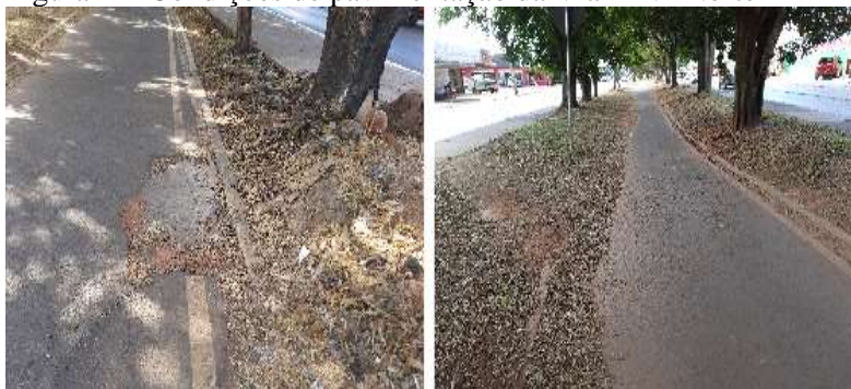
Figura 14- Condições de pavimentação da Via MN2 Norte
