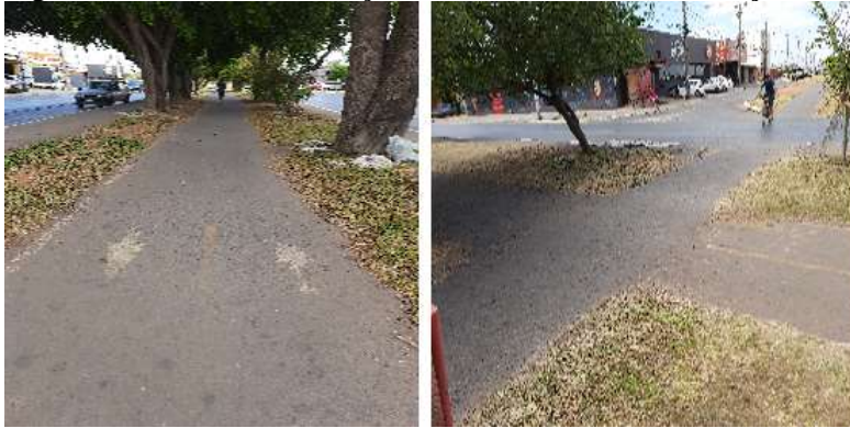
Figura 9- Análise das condições da via MN2 Sul (sinalização horizontal)
