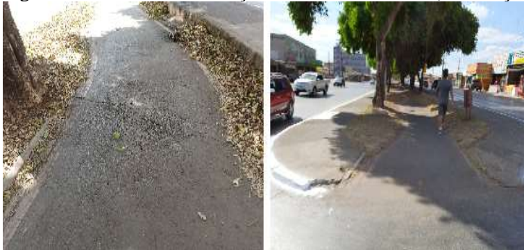
Figura 12- Análise das condições da via MN2 Norte (sinalização horizontal)
