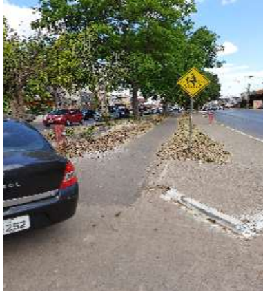
Figura 10 - Análise das condições da via MN2 Sul (sinalização vertical)
