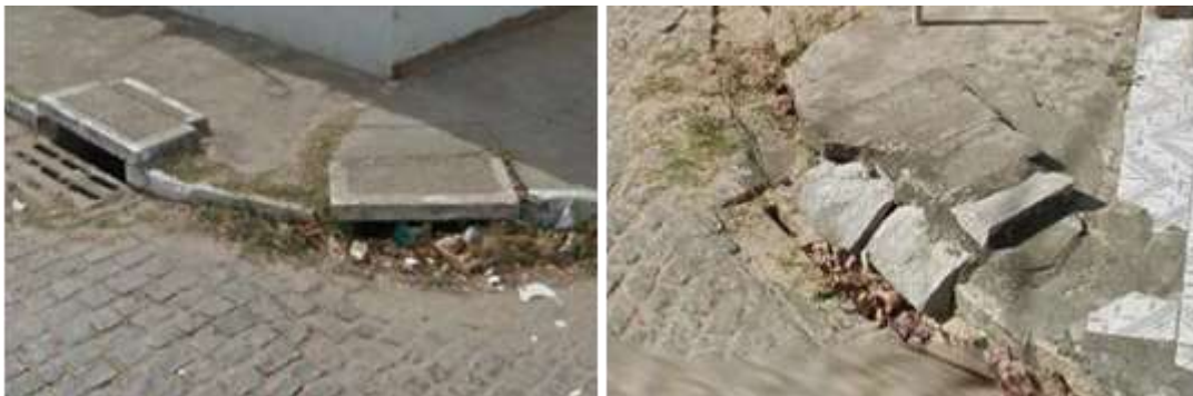
Figura 5 e 6 – Situação atual das bocas de lobo - Gramoré. Fonte: Núcleo de Pesquisa e Extensão Acesso a Terra Urbanizada/ REURB-S.
