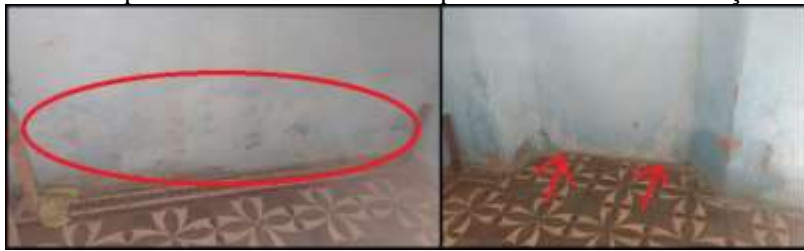
Figura 3. Destacamento da pintura e eflorescência em parede interna da edificação.
