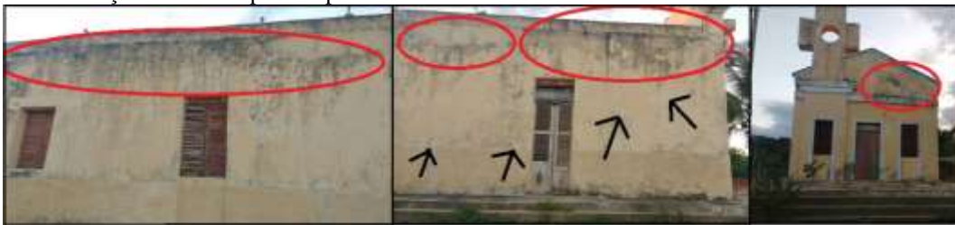
Figura 1. Presença de bolor na parte superior das fachadas lateral.
