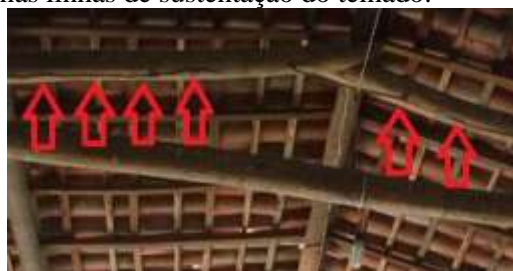
Figura 4. Presença de cupim nas linhas de sustentação do telhado.
